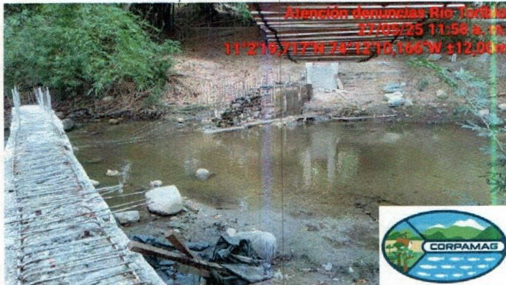
Vista del cauce del Río Toribio parcialmente obstruido por estructuras de concreto y hierro – evidencia de posible alteración del flujo hídrico
