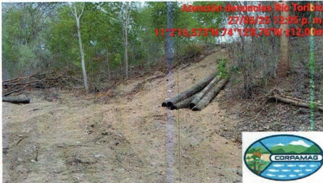
Ingreso rústico con pendiente intervenida y disposición de tubería en desuso –elementos presuntamente desenterrados
