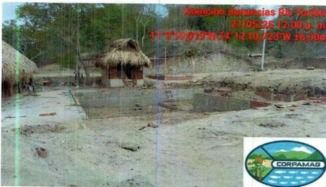
Construcción de infraestructura en etapa de cimentación – zona alta contigua al Río Toribio
