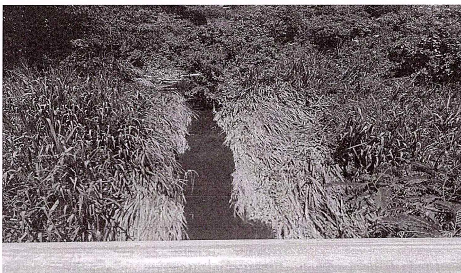
FOTO 1. Estado actual del cauce y densa cobertura vegetal
