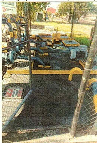
Imagen 8. Tanque Car dumper doble de allí el agua es bombeada para potabilización a diferentes áreas del puerto.
