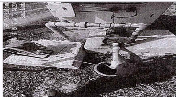
Foto No. 3. Pozo profundo Granja El Porvenir Fuente: [Fotografías digitales]/ Kerby Jordi; 28 de abril 2025, Guachaca, zona rural de Santa Marta
