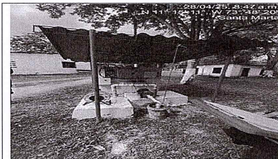
Foto No. 2. Pozo profundo Granja El Porvenir Fuente: [Fotografías digitales]/ Kerby Jordi; 28 de abril 2025, Guachaca, zona rural de Santa Marta
