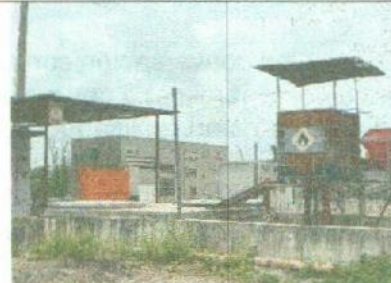
Fotografía 6: zona de generadores.
