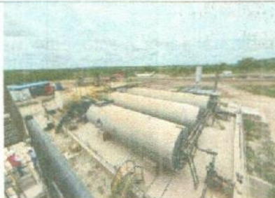
Fotografía 5: tanques de almacenamiento bitumen.
