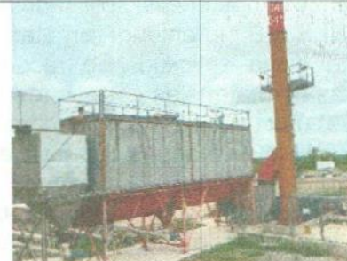
Fotografía 4: casa de filtros de mangas.
