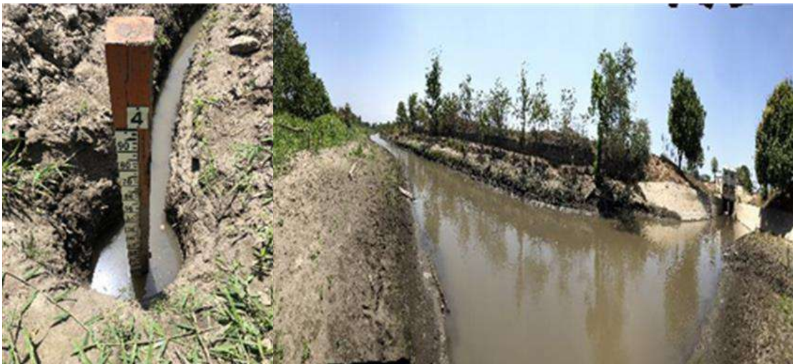
Figura 14. Condición del Caño El Renegado en el mes de febrero de 2020.
