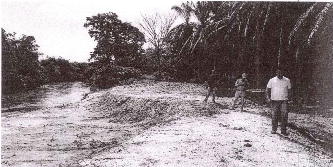
9 septiembre de 2016. Dique construido en garrapata 2 reconformado parcialmente de forma provisional debido a erosión causada por árbol caído que obstruyó flujo y desvió el cauce del río Tukurinca
