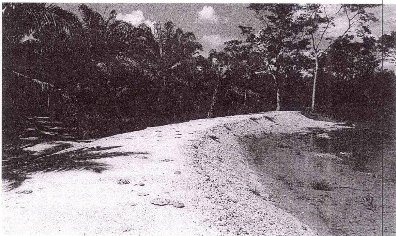
9 noviembre 2016. Dique en punto denominado Garrapata 3
