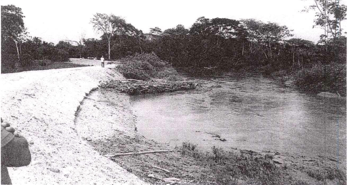
25 noviembre de 2016. Erosión en talud ocasionada por árboles caídos en Garrapata 1
