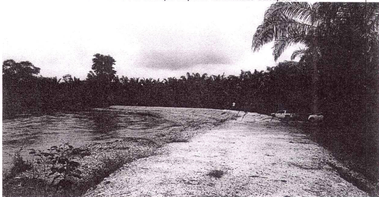
25 noviembre 2016. Estado del Dique en Garrapata 3 en la fecha indicada
