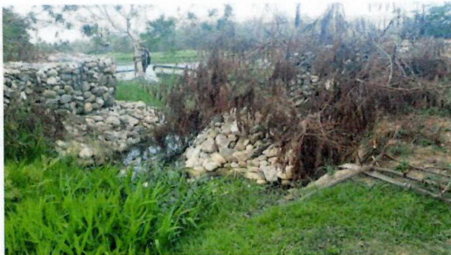
Ilustración 16. Fallos en la malla de confinamiento estructura actual.
