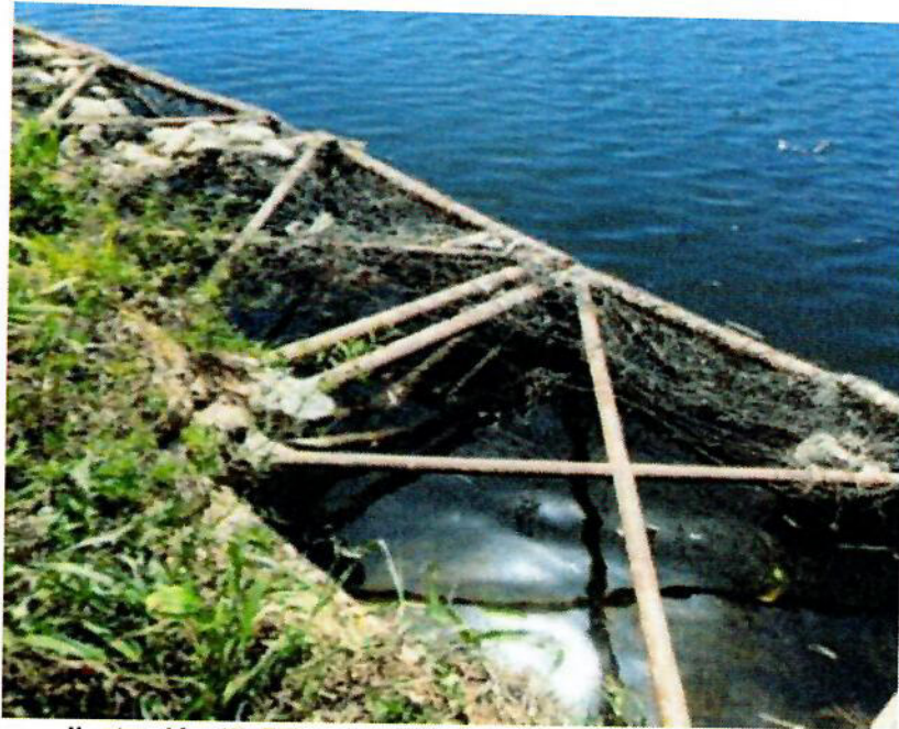
Ilustración 17. Fallos en la estructura de protección de orillas.
