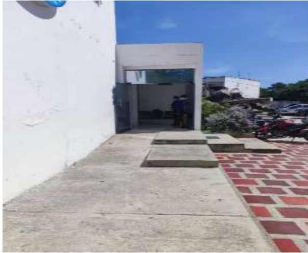
Pared color blanco y piso de color gris (contraste de acuerdo a la norma)
